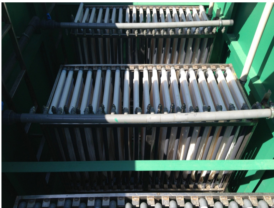
Рис. 6. Мембранный блок с погружными полуволоконными модулями установки производительностью 200 м 3 /сут в Московской области перед пуском в работу
